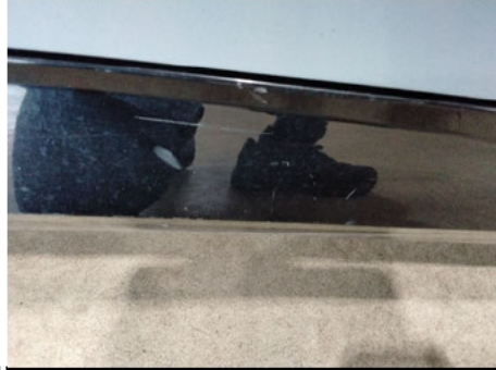
Schwellerverkleidung / Links / Kratzer
