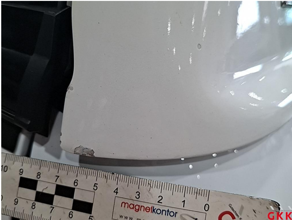
Bild 52. Kabinenaufbau hinten, Lackierung verätzt, lackieren
