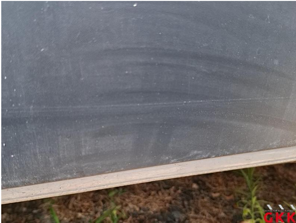
Bild 82. Seitenwand links, Leiste -unten-, verkratzt, ersetzen
