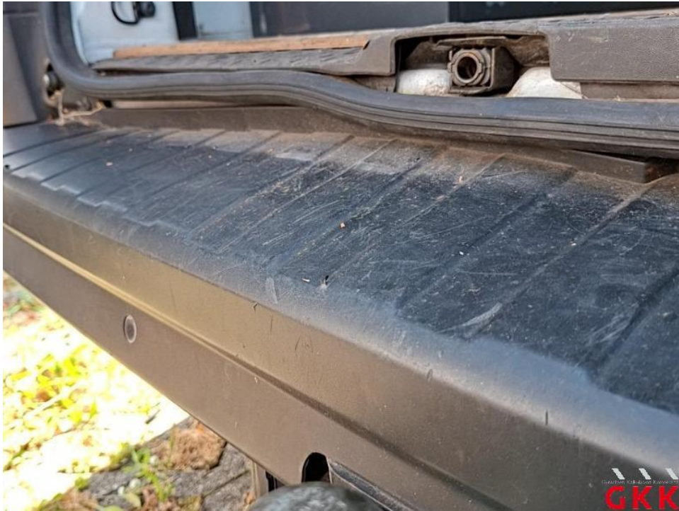
Bild 71. Stoßfänger hinten, Verkleidung -unlackiert-, beschädigt, ersetzen
