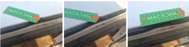
Door hinge RL top, Broken, Replace
