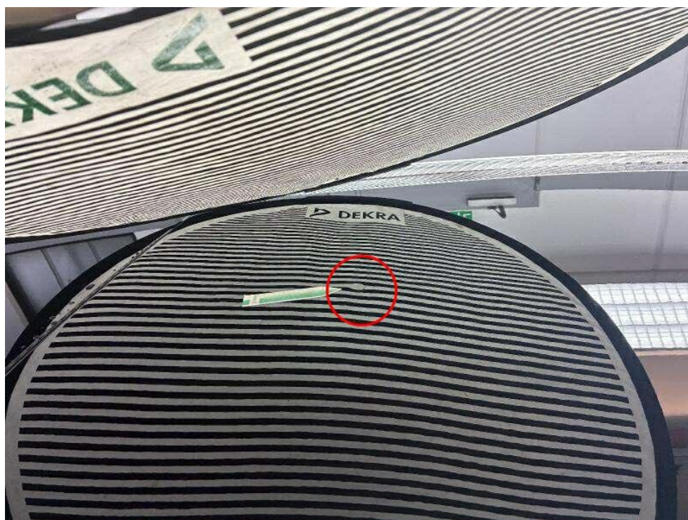
Bild 24 : Dach, eingedellt, drücken
