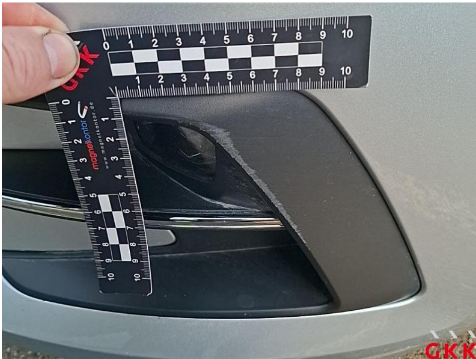
Bild 17. Stoßfänger vorne, Blende -unlackiert-, verkratzt, ersetzen
