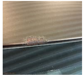
Skadebild Rost tak
