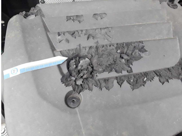
Beschädigung #1: Motor: Motorabdeckung - beschädigt - erneuern
