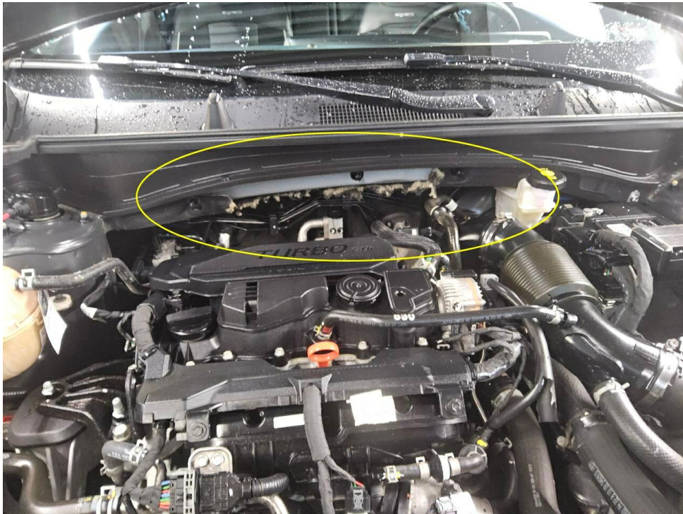
Bild 17 : Stirnwand, Dämmmatte zerrissen
