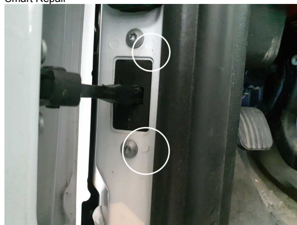
Beschädigung #13: Karosserie: A-Säule links - gebrochen / gerissen - instandsetzen und lackieren
