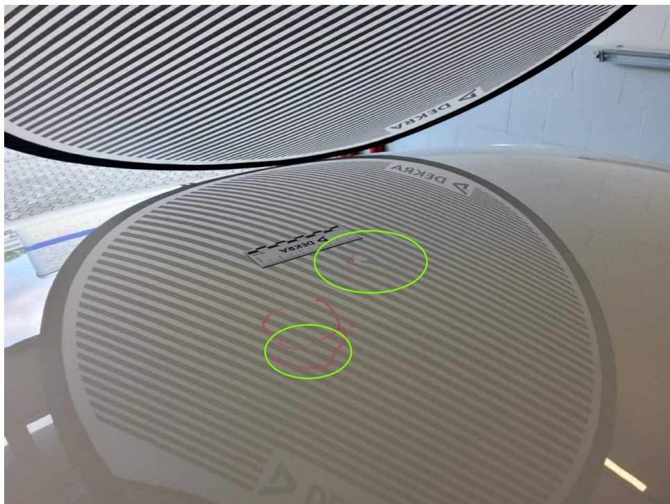
Bild 22 : Dach, mehrfach eingedellt, Gebrauchsspur
