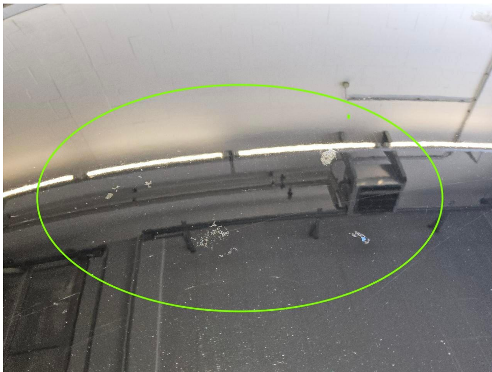
Bild 27 : Dach, Umwelteinflüsse Lackschaden
