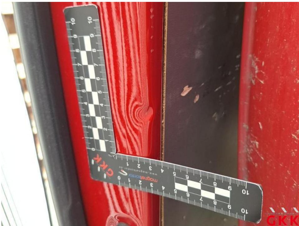
Bild 34. Schiebetür rechts, beschädigt, instand setzen - lackieren
