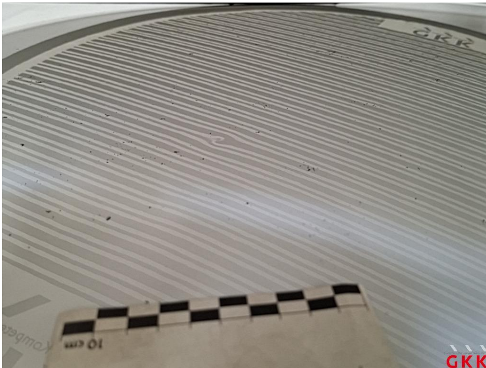
Bild 30 Dach, Hagelschaden, kalt drücken
