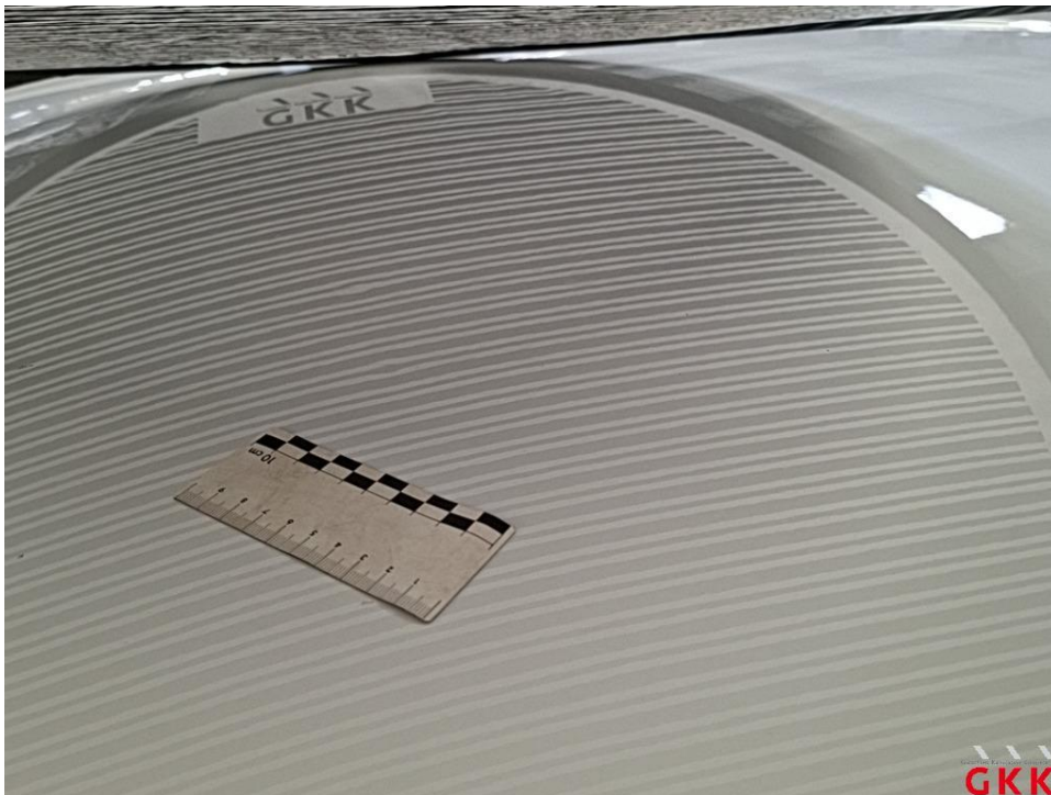
Bild 32 Dach, Hagelschaden, kalt drücken
