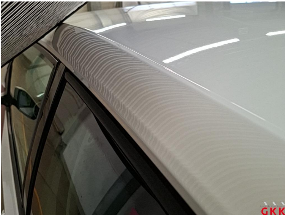
Bild 34 Dach, Hagelschaden, kalt drücken
