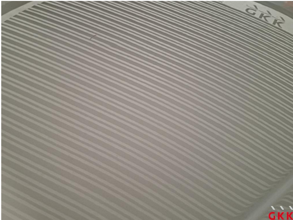
Bild 33 Dach, Hagelschaden, kalt drücken
