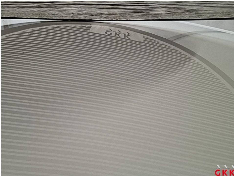
Bild 31 Dach, Hagelschaden, kalt drücken
