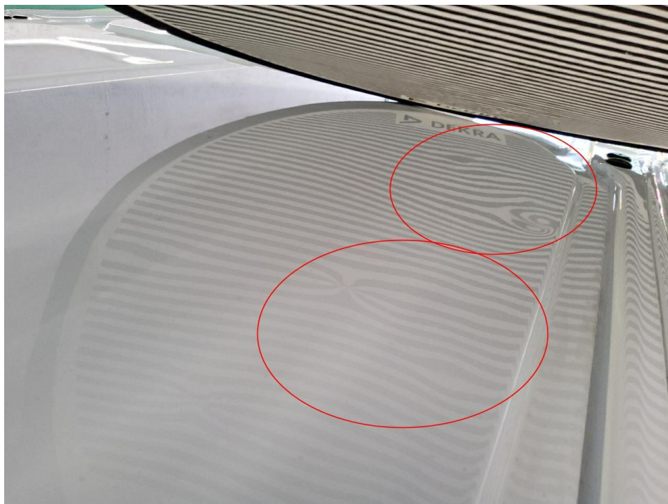
Bild 25 : Dach, mehrfach großflächig eingedellt
