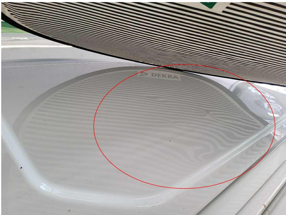
Bild 24 : Dach, mehrfach großflächig eingedellt
