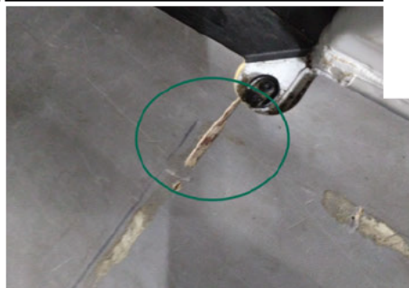
Holzboden / Hinten / Abgewetzt
