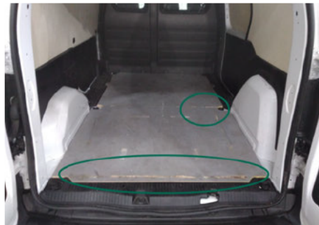
Holzboden / Hinten / Abgewetzt
