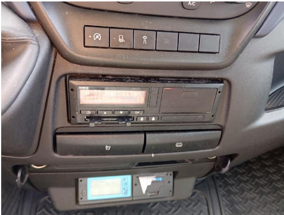
Bild: 11 Kühlsteuerung mit Überwachung
