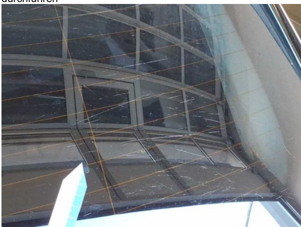
Beschädigung #8: Verglasung: Heckscheibe - Kratzer - erneuern
