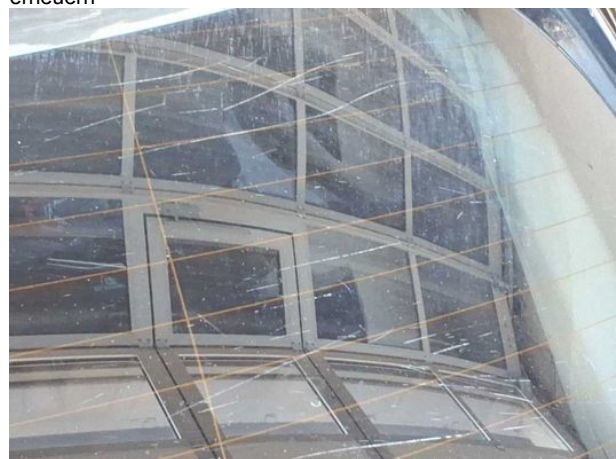
Beschädigung #8: Verglasung: Heckscheibe - Kratzer - erneuern
