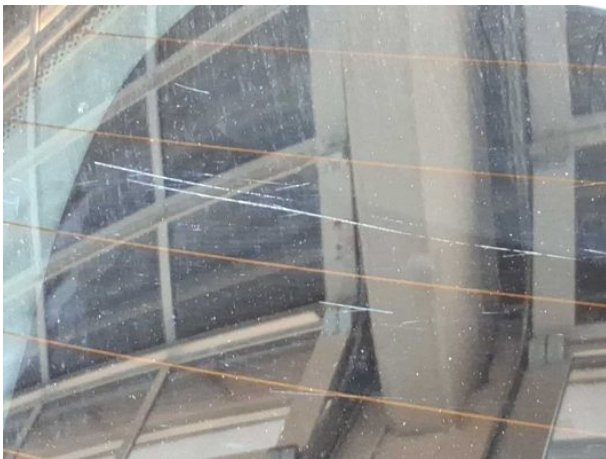
Beschädigung #8: Verglasung: Heckscheibe - Kratzer - erneuern
