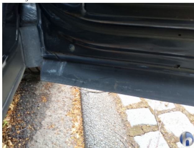
1. Tür Vorne - Rechts Riss - Erneuern
