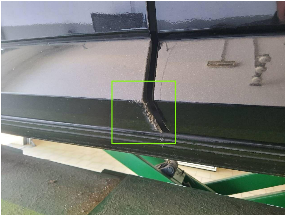
Bild 19 : Blende Tür vorne links verschrammt mit Materialabtrag
