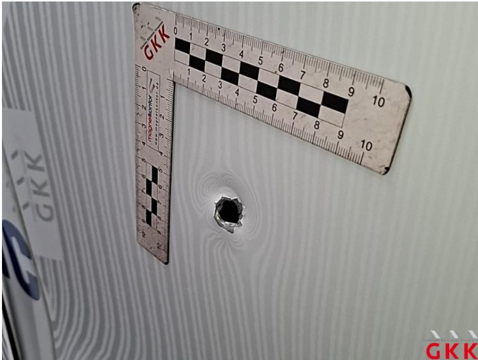
Bild 58. Schiebetür rechts, beschädigt, ersetzen
