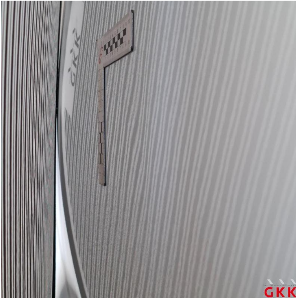
Bild 35. Seitenwand links, vorne, Reparaturmangel, instand setzen - lackieren
