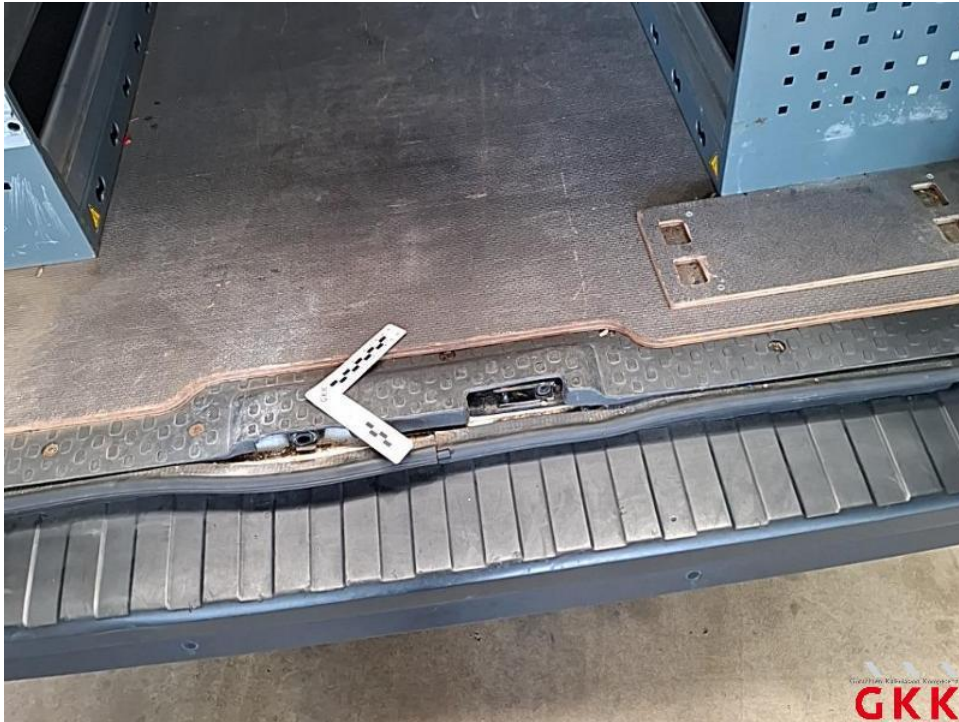
Bild 43. Ladekante, Abdeckung, beschädigt, ersetzen
