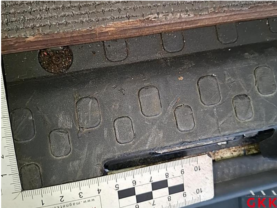
Bild 45. Ladekante, Abdeckung, beschädigt, ersetzen
