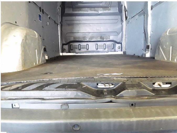
Beschädigung 11: Interieur: Laderaumboden - verformt - erneuern
