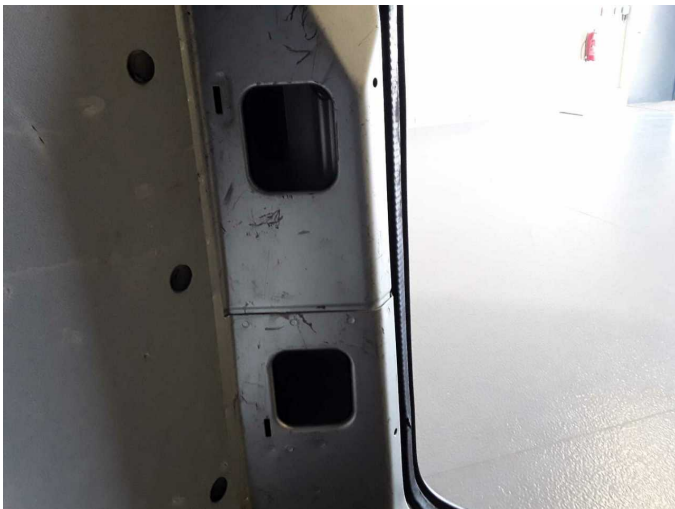
Beschädigung 5: Verkleidungen/Abdeckungen: D-Säule rechts Verkleidung innen - fehlt - erneuern
