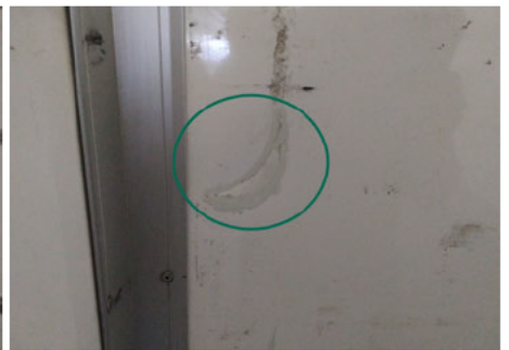
Seitenwand / Vorne / Gebrochen
