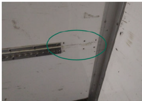
Aufbauprofil / Vorne Links / Fehlt
