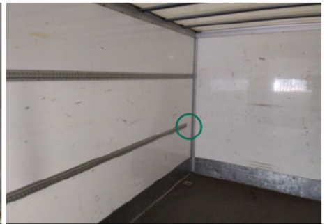
Aufbauprofil / Vorne Links / Fehlt
