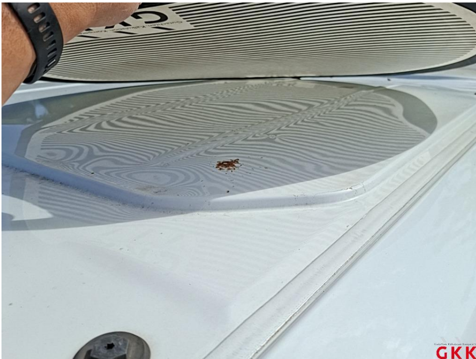
Bild 16 Dach, beschädigt, ersetzen
