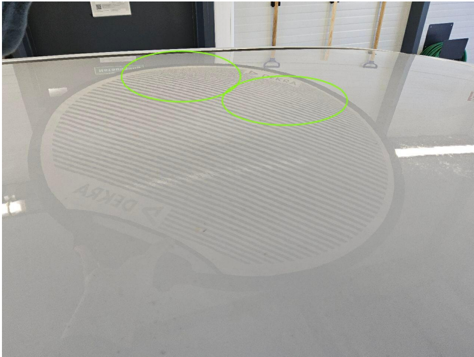
Bild 13 : Dach, Restspuren aus Instandsetzung, noch Dellen vorhanden
