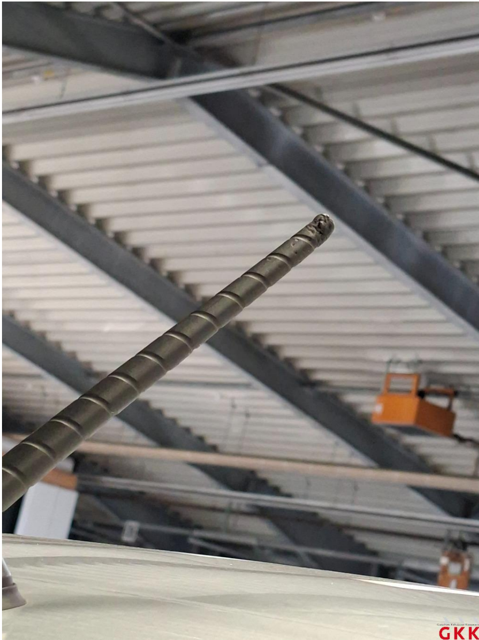
Bild 19 Antenne, Stab, beschädigt, ersetzen
