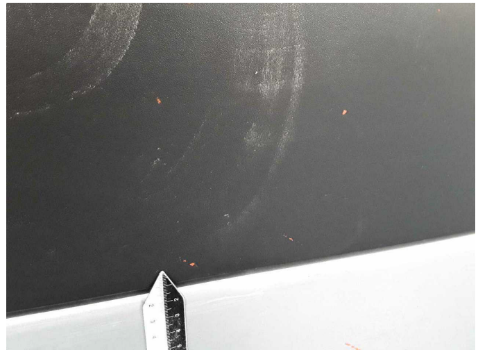
Beschädigung 15: Schiebetür rechts: Schutzleiste - beschädigt - erneuern
