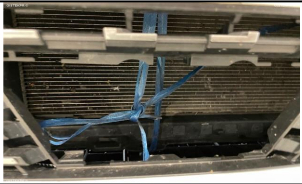
Foto daños externos 1
