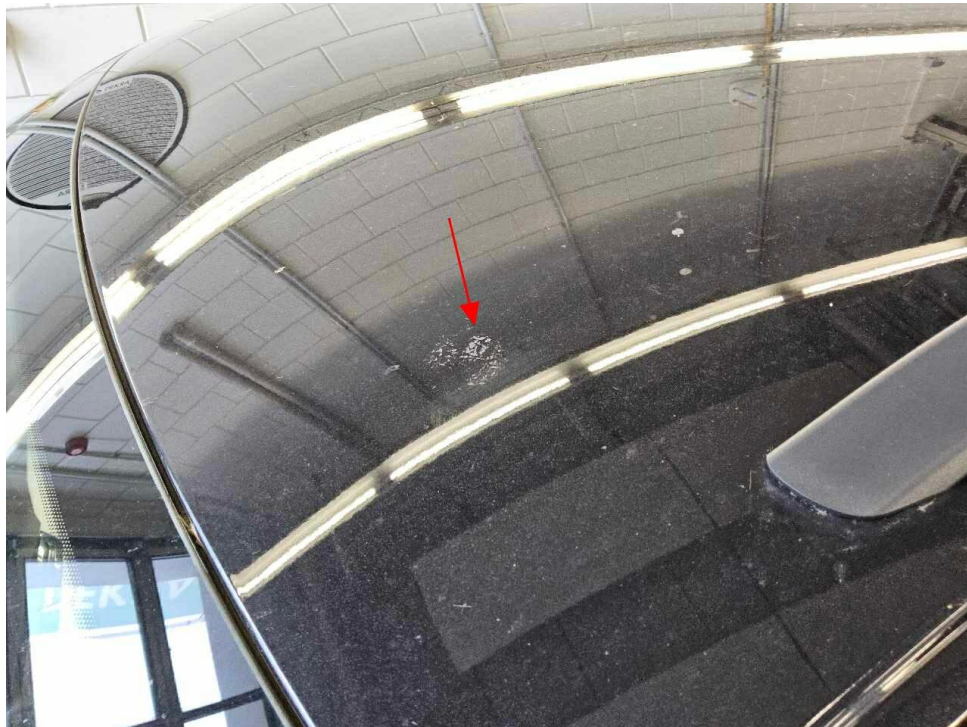
Bild 23 : Dachholm, Dach Lackverätzungen
