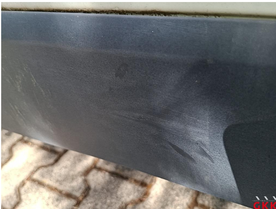
Bild 27. Seitenwand links, Leiste -unten-, beschädigt, ersetzen
