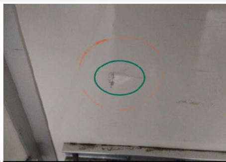
Seitenwand / Vorne / Gebrochen
