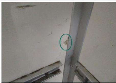
Seitenwand / Vorne / Gebrochen
