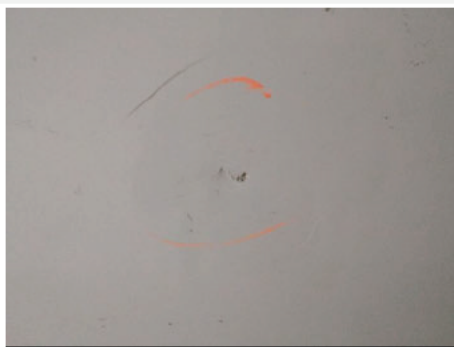
Seitenwand / Links / Gebrochen
