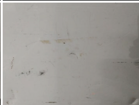
Seitenwand / Links / Gebrochen
