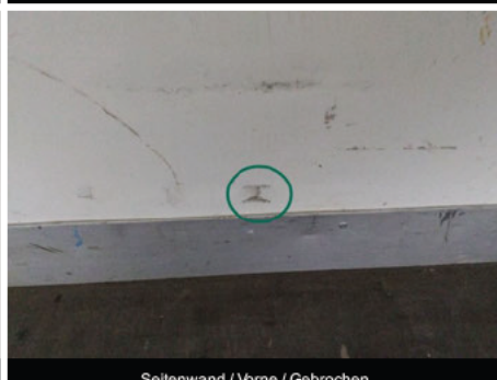
Seitenwand / Vorne / Gebrochen
