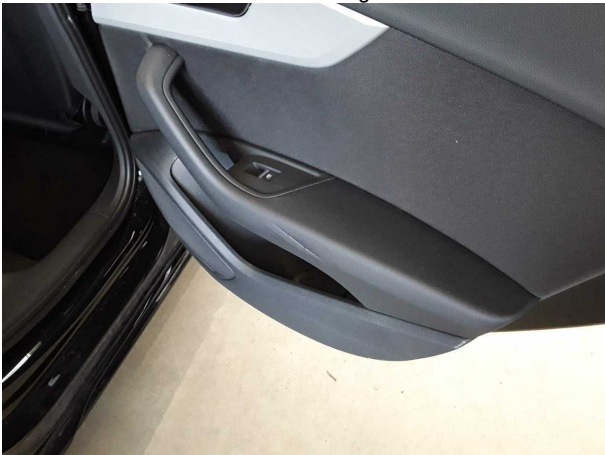
Beschädigung #2: Verkleidungen/Abdeckungen: Türverkleidung hinten rechts - verformt - Wertminderung
