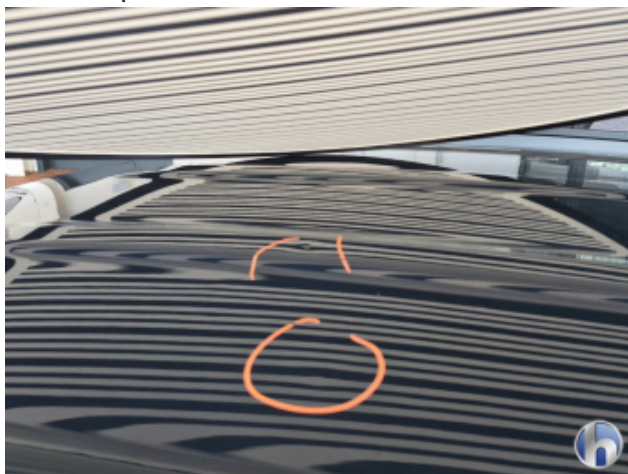
2. Dach Gebrauchsspuren - Nacharbeiten
