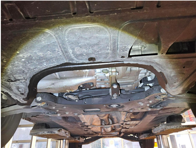
Bild 17: Technik, Motor, undicht, prüfen und Befund festlegen, Schaden- erweiterung möglich
