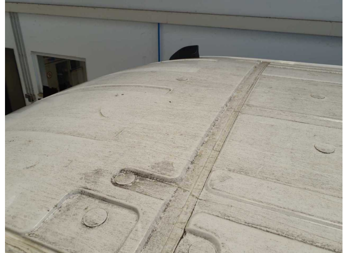
Damage 9: Roof: Roof (Mehrkosten möglich) - Soiled - Conditioning
