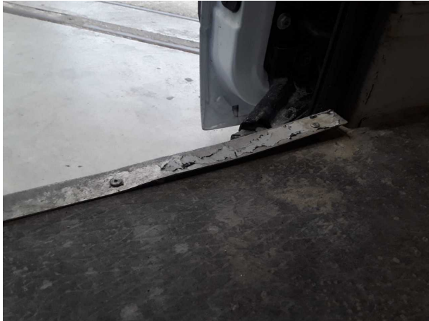
Beschädigung #1: Interieur: Laderaumboden (Leiste) - lose - de-/montieren
