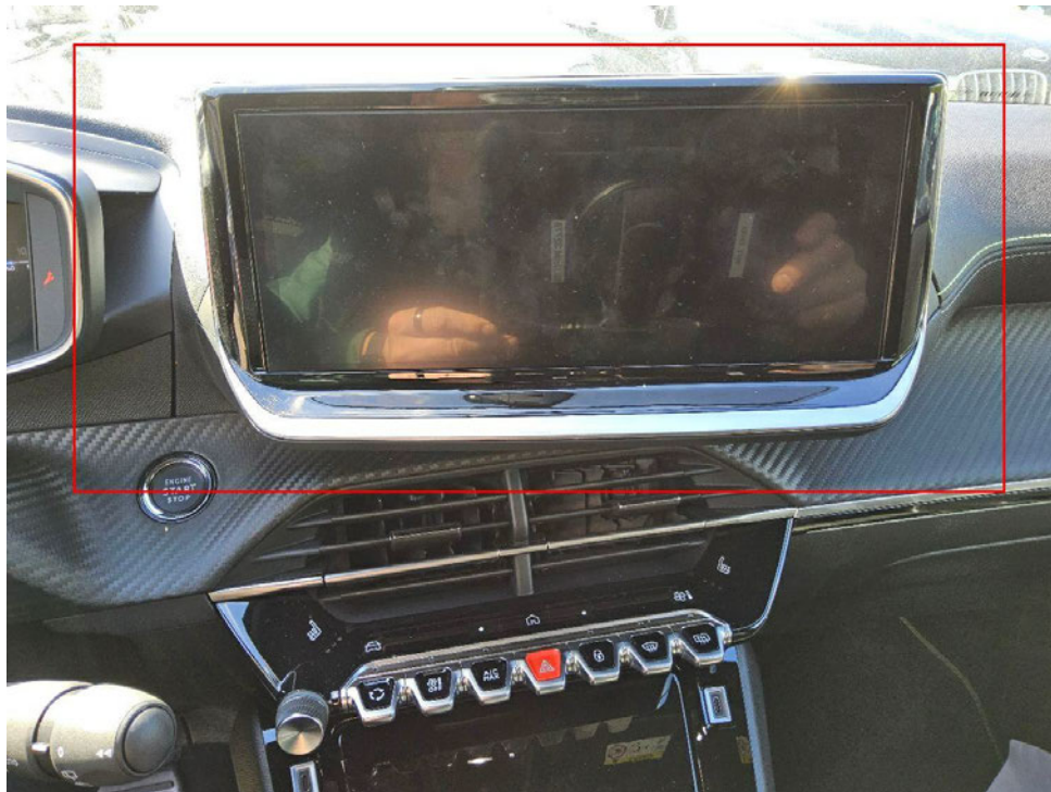
Bild 7 : Elektrik Displays, ohne Funktion, prüfen und Befund festlegen, Schadenerweiterung möglich
