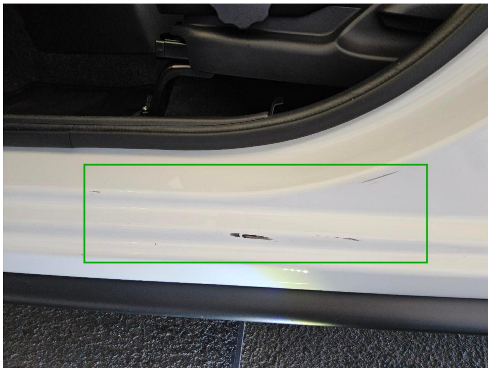
Bild 17 : Tür vorne links und Einstieg , Klebereste
