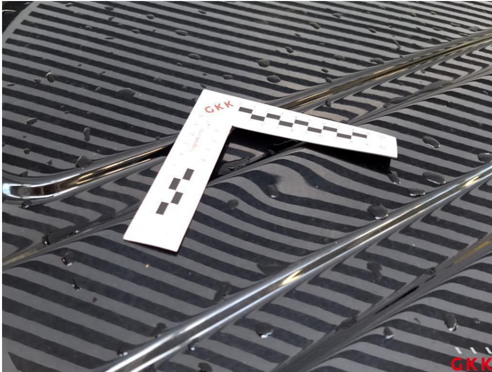
Bild 17 Dach, beschädigt, instand setzen - lackieren
