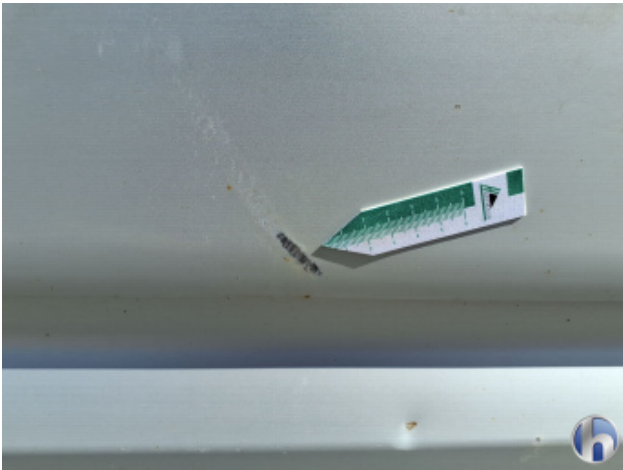
1. Seitenwand - Hinten - Links Beschädigt - Instandsetzen und Lackieren
