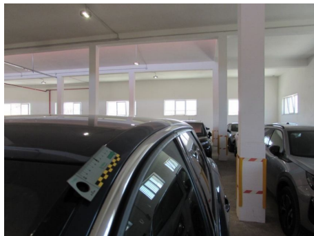
Montante tetto / Sinistro / Rientranza da Grandine
