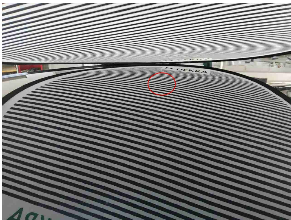
Bild 31 : Dach. mehrfach gedellt und Umweltschäden
