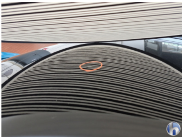
2. Dach Gebrauchsspuren - Ohne Reparatur
