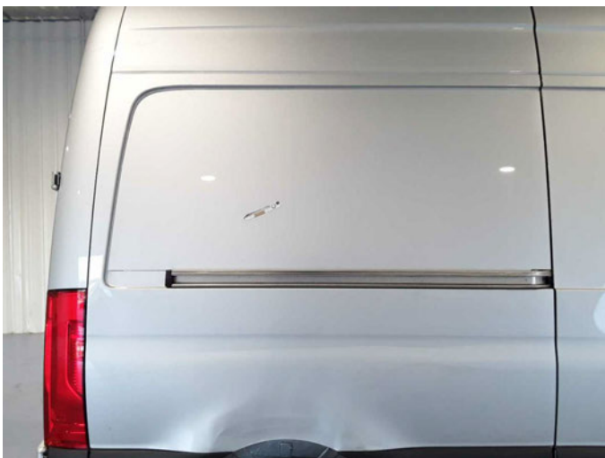
Beschädigung 18: Seitenwand rechts: Seitenwand - verformt - instandsetzen/lackieren (S3)
