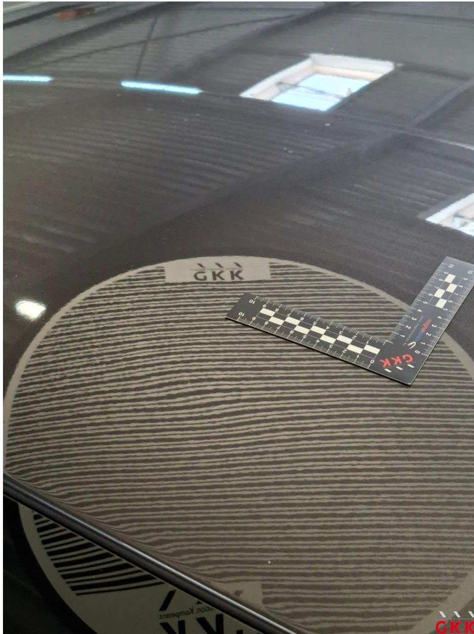
Bild 18 Dach, beschädigt, instand setzen - lackieren
