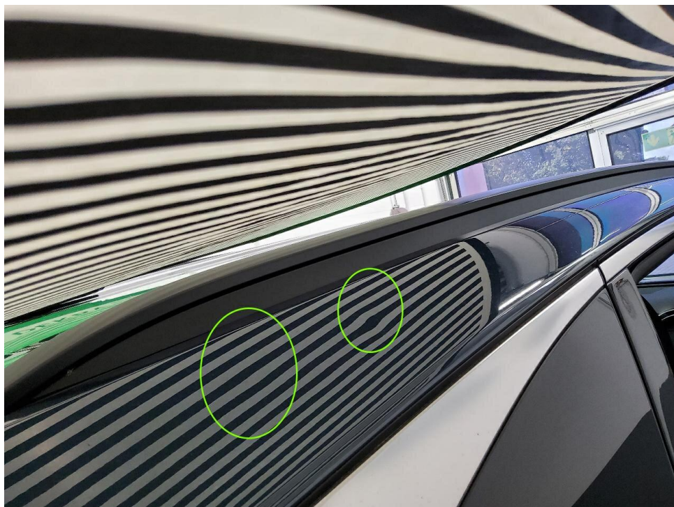
Bild 20 : Dachholm rechts eingedellt
