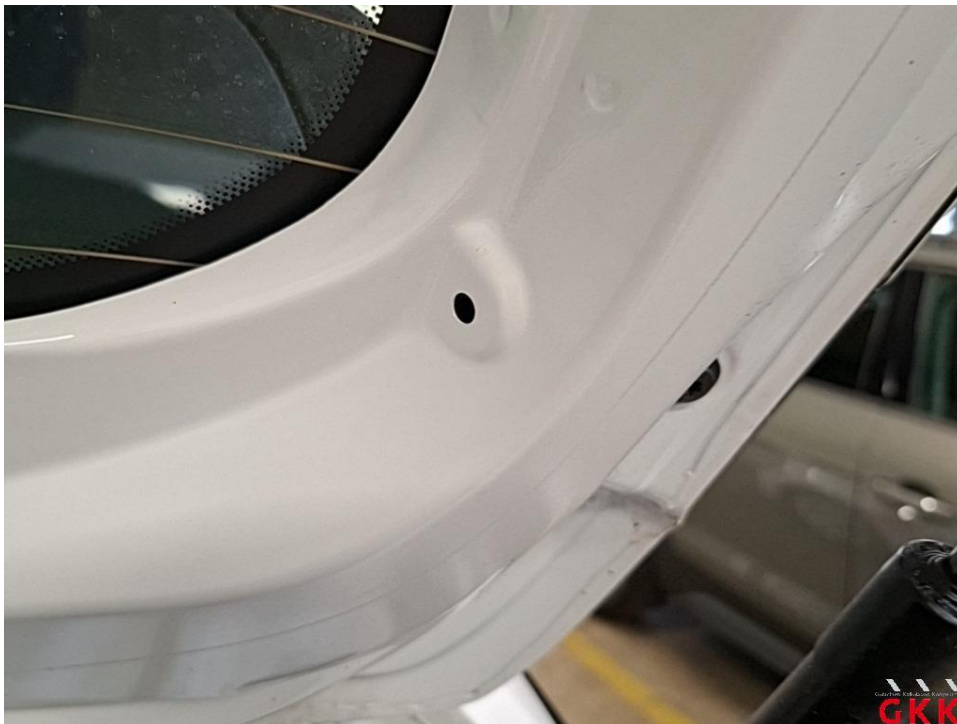
Bild 16 Laderaum, Abdeckung -Halteseil-, fehlt, ersetzen
