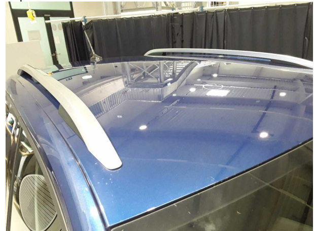
Beschädigung #4: Fahrzeugdach: Dach - Delle(n) - sanft instandsetzen
