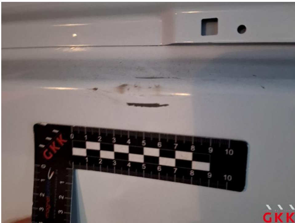
Bild 76. Trennwand, verkratzt, Smartrepair
