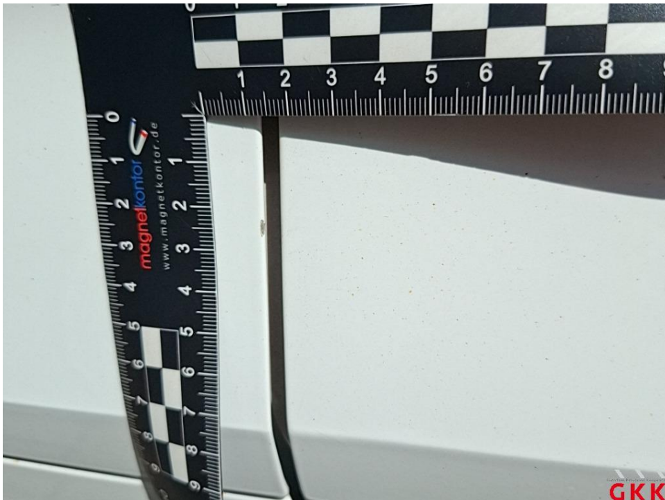
Bild 22. Tür vorne links, Kante, beschädigt, auslegen, schleifen, polieren
